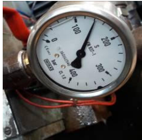
Fig. 8 Dettaglio del manometro utilizzato
